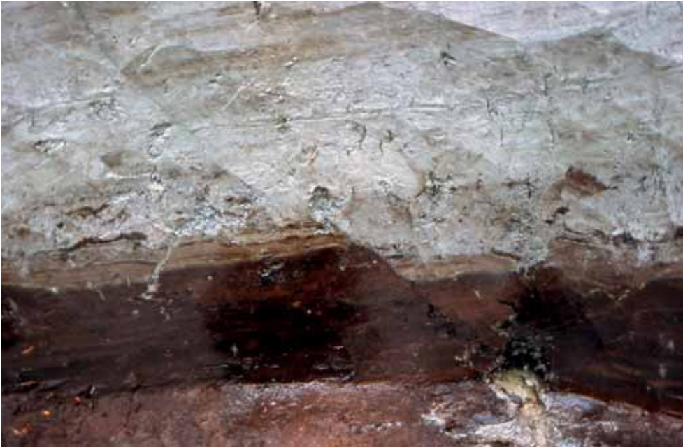
FIG. 64 Kleine breuken in het oppervlakteveen onder de dijk. Small faults in the surface peat below the embankment.
