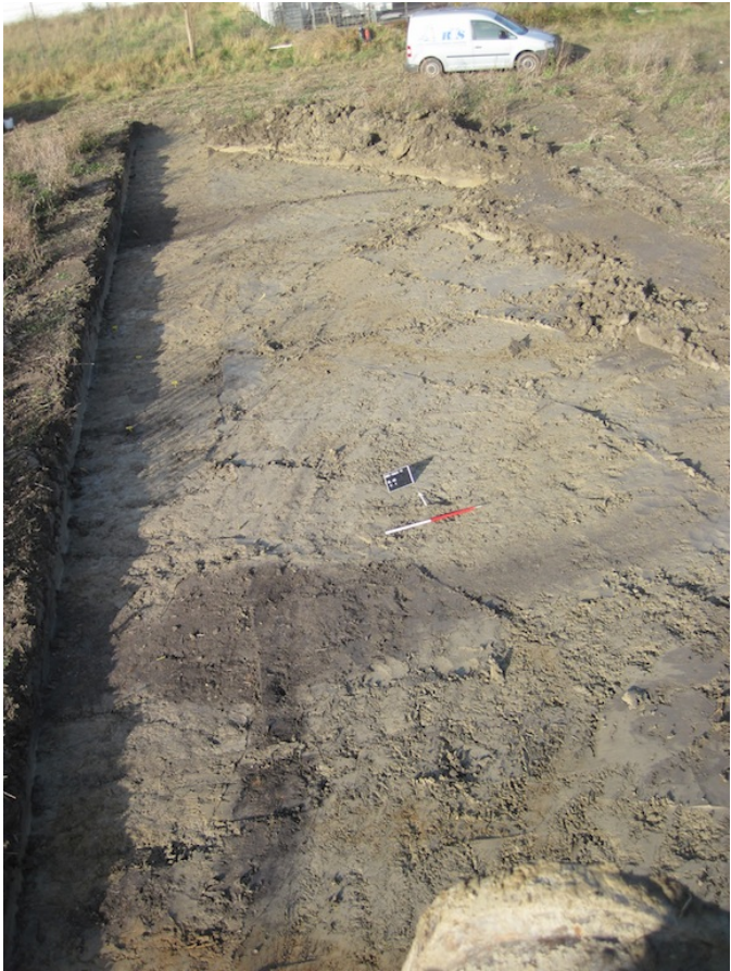
Fig.57 : Foto SL 45 KV 1
