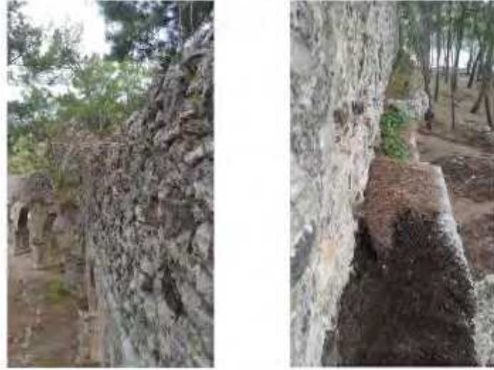
Fig. 108. Kemer Üzerinde Bulunan Moloz Duvarın ve Pervazın Temizlenmeden Önceki Durumu
