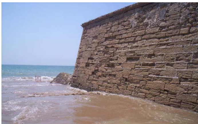
Lámina II. La cota se eleva en la zona del fuerte de Cortadura evitando que el mar cortara el paso con las mareas.
