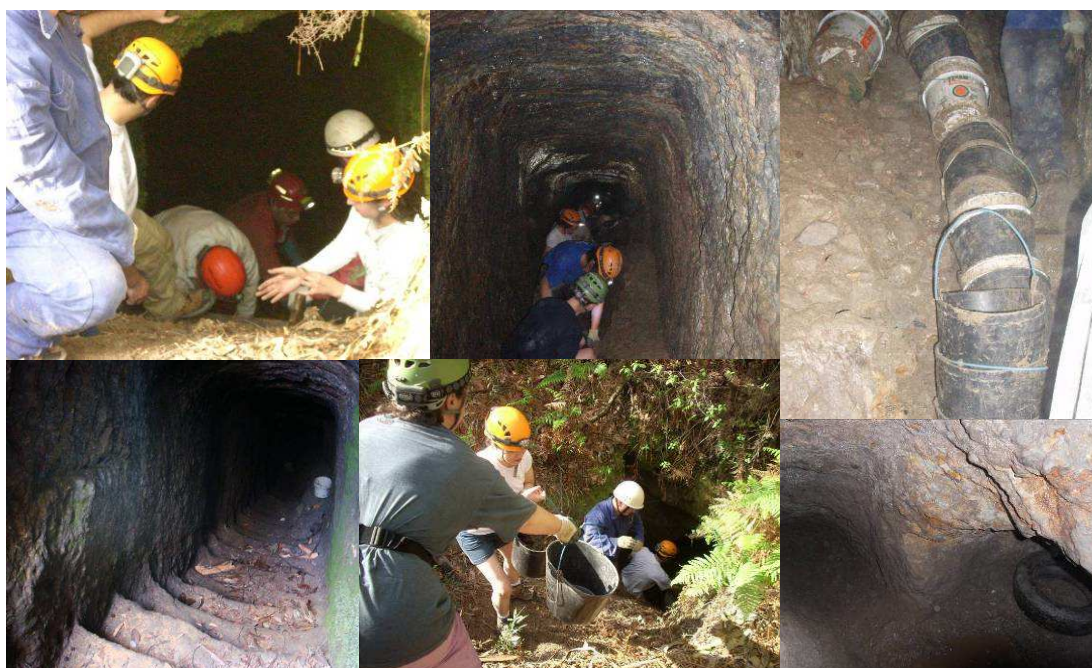
Figura 7: Fotografias de alguns dos trabalhos de desobstrução da Escadaria i (fotografias Vítor Gandra – ARCM)
