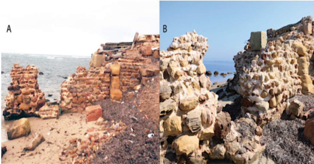
Fig. 19 : Exemple d'érosion accélérée menaçant les vestiges archéologiques à Carpis
