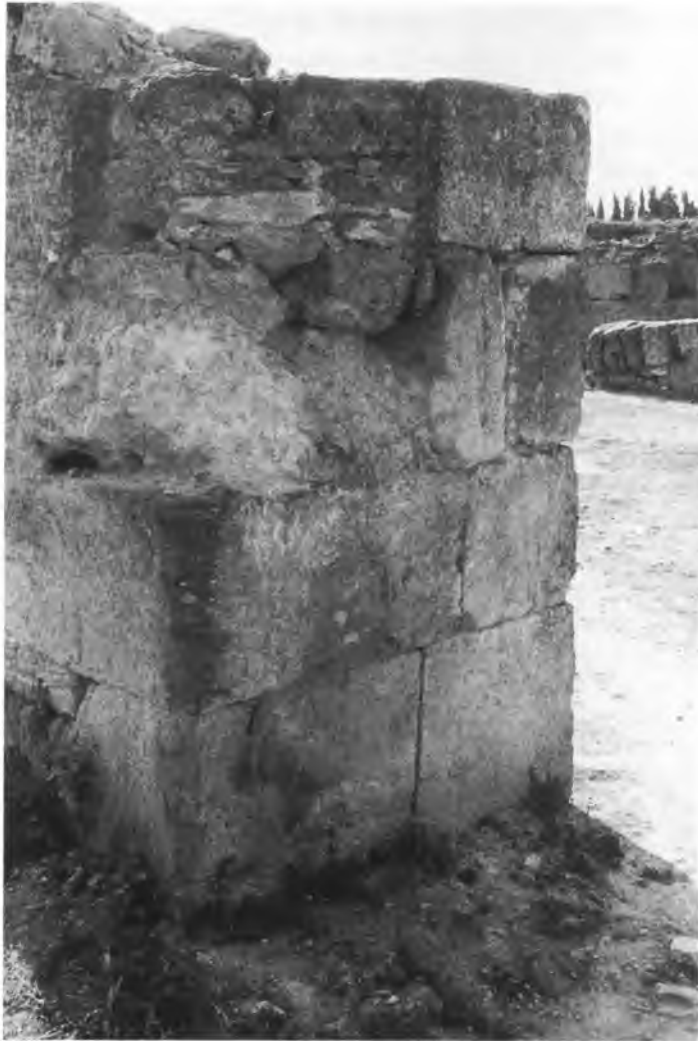
Photo 11. Montant E de la porte 20-ex cours VI. On distingue les traces laissées par la combustion d'un encadrement qui permettait le mouvement des portes.
