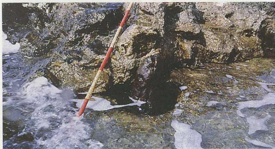
Fig. 6 - Anzio, porto neroniano: molo ovest, blocco III, palificazioni allo scoperto dopo un crollo.
