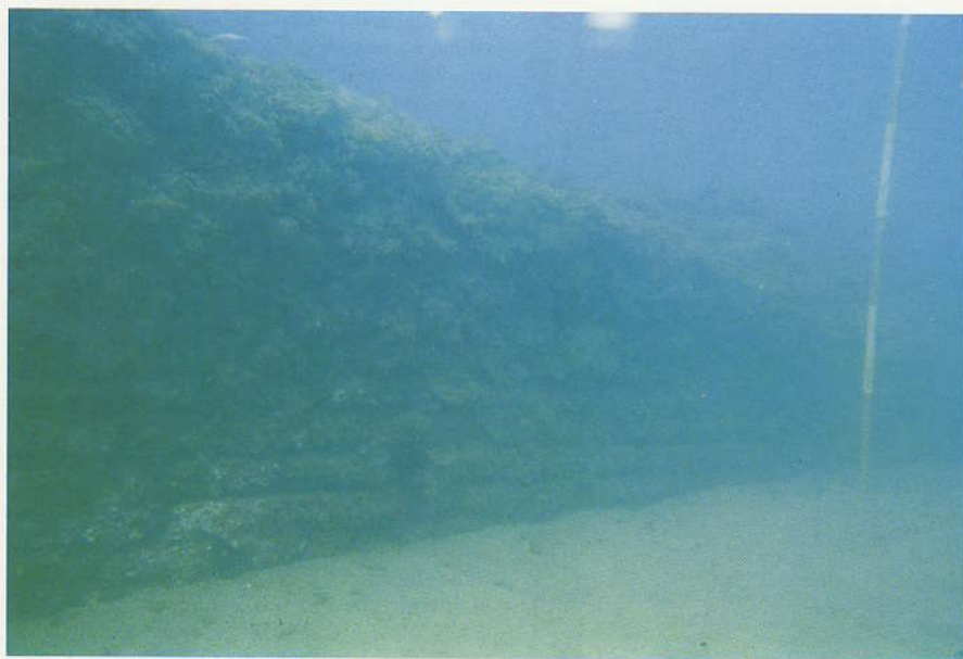
Fig. 4 - Anzio, porto neroniano: molo est, un crollo immerso rivestito in laterizio, da est.
