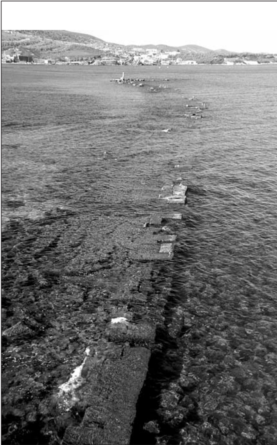
ΕΙΚ. 8. Ο ανατολικός λιμενοβραχίονας του βόρειου λιμανιού της Μυτιλήνης. Διακρίνονται ο ιδιαίτερος τρόπος προσαρμογής των λίθων, η γωνίωση, καθώς και η λιθορριπή έδρασης για την εξυγίανση του θαλασσιού πυθμένα, προκειμένου να καταστεί εφικτή η κατασκευή αυτού του τεράστιου τεχνικού έργου.
