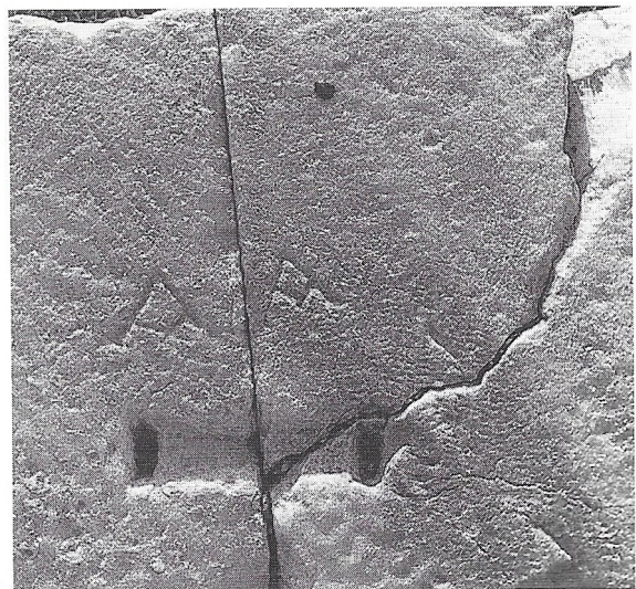
Fig. 3. — Marques de montage sur l'exèdre demi-circulaire à l'Ouest de l'Agora de Théophrastos.
