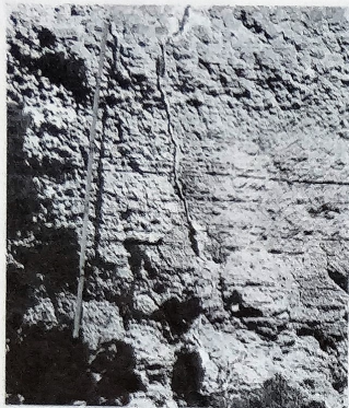
Falasarua. Une fissure traverse la paroi extérieure du vivier (?) sur toute la hauteur. (Cliché P.A. Pirazzoli).
