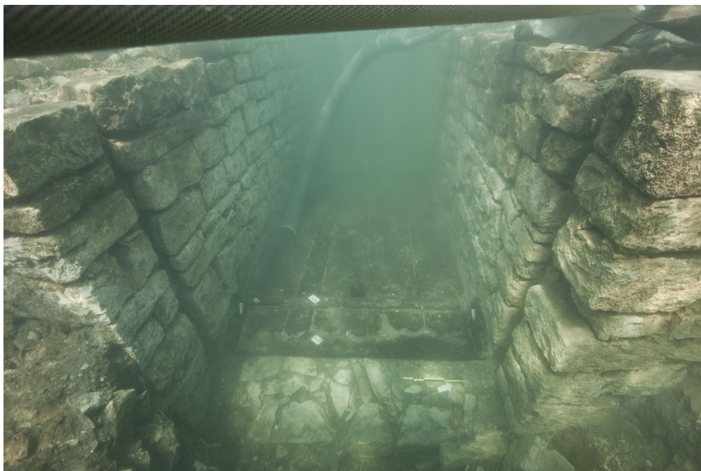
Fig 12 - La martelière entre les bassins A et B.
