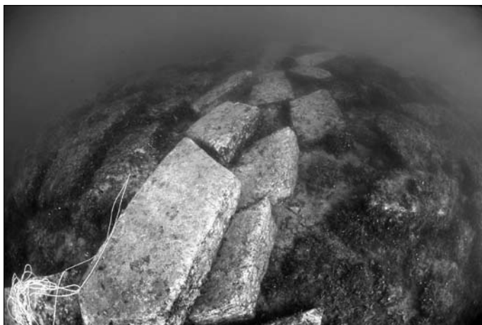
Fig. 13 – La cortina del lato Nord con i blocchi dissestati dall'azione del moto ondoso.
