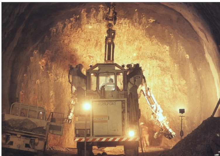
FIG. 1.3 – Jumbo au travail sur le tunnel des Pennes-Mirabeau (TGV Méditerranée). Doc Eiffage.
