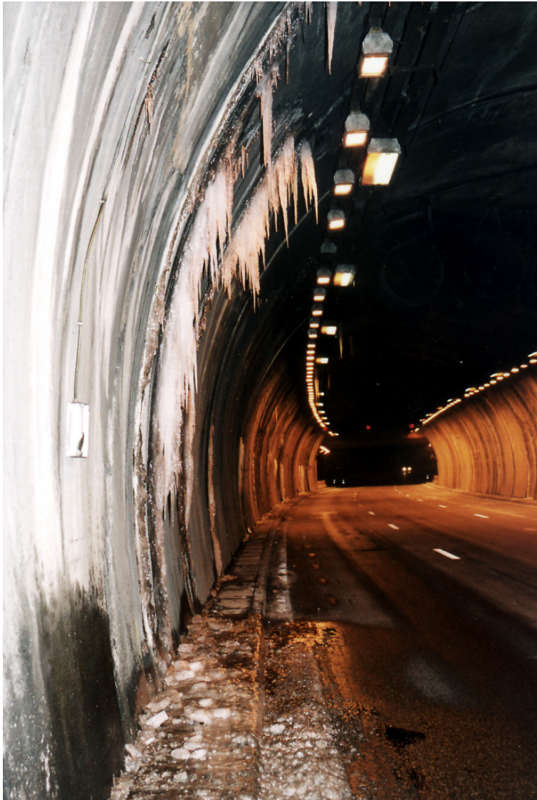
FIG. 1.15 – Stalactites de glace dans le tunnel des Monts en 2002, montrant la présence de défauts dans l'étanchéité du tunnel (Doc. Cetu). Ce tunnel a fait l'objet d'une rénovation lourde en 2005.
