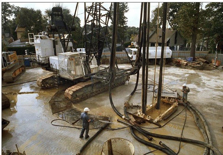
FIG. 1.13 – Creusement de parois moulées avant l'excavation du puits de la Place Berthet sur le chantier de l'A86 (Doc. Socatop 2001)
