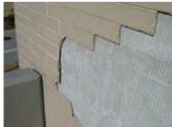
Figure 79 : décollerement de carreaux [SA 05]
