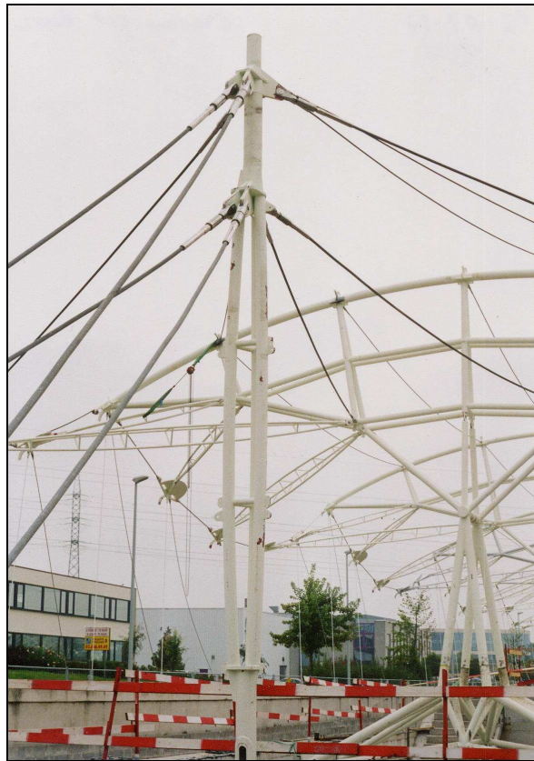
Câbles de contreventement d'une ossature métallique devant être couverte d'une toile tendue. Sur la photo les câbles n'ont pas encore été complètement tendus. (Station de Métro Erasme, Bruxelles, 2003 – architectes et ingénieurs Samyn and Partners avec le bureau d'études Setesco; Photo Guy Clantin).
