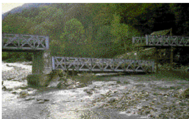
Un pont effondré à cause de l'abaissement du lit.
