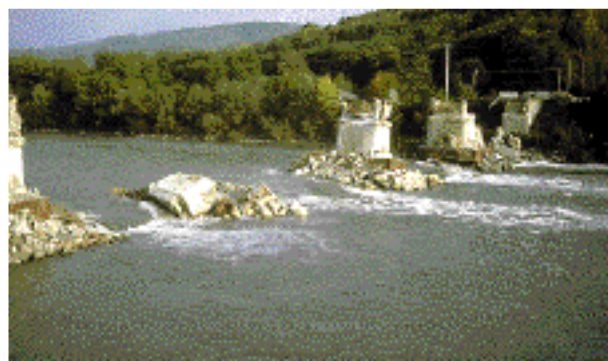
Le pont des Mollettes sur l'Isère. L'ouvrage, fortement affouilli en 1979, s'est effondré en 1981. La multiplication de ce type d'accidents a mis en évidence le coût économique d'une absence de gestion du transport solide des cours d'eau.
