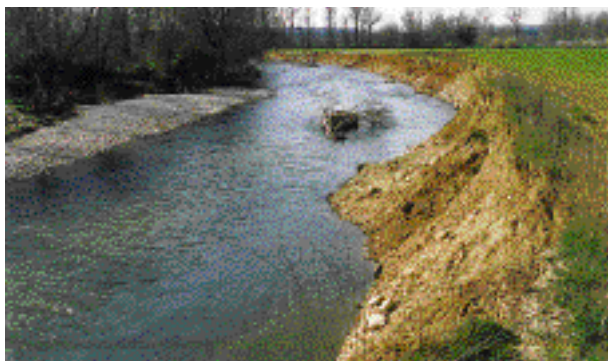
Érosion de berges sur l'Arc, dans les Bouches-du-Rhône.
