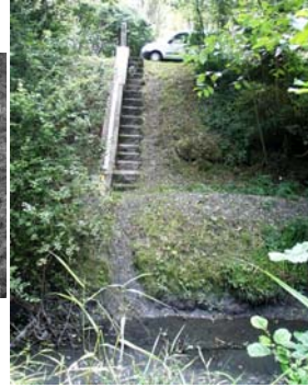
échelle ensablée sur l'Isère à Villard-Bonnot
