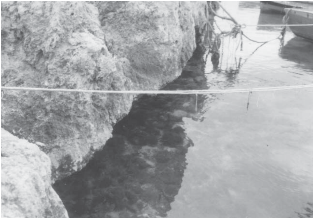
66.03. Encoche d'érosion horizontale dans la paroi au Sud-est du bassin.
