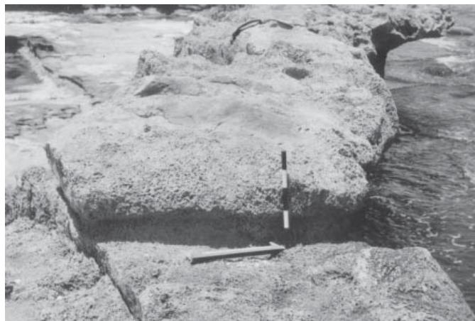
19.73. Borne d'amarrage n° 28 entamée par l'extraction de la roche (2003).
